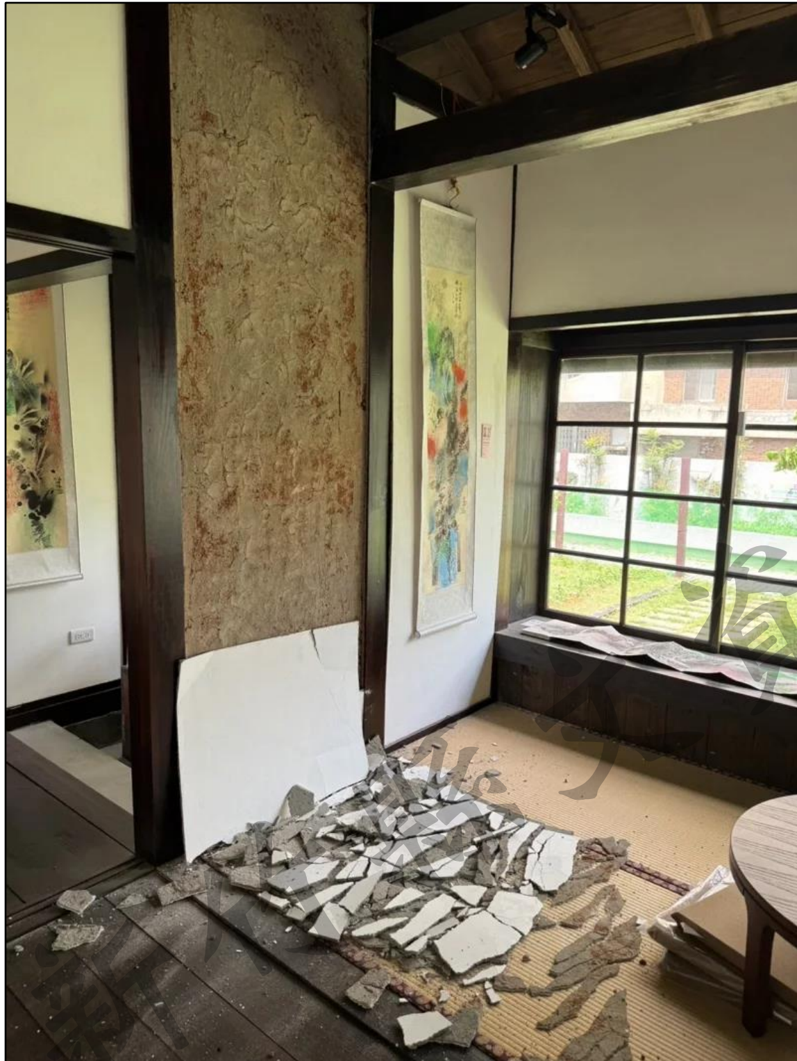
楊梅茶業改良場宿舍灰泥壁崩落
