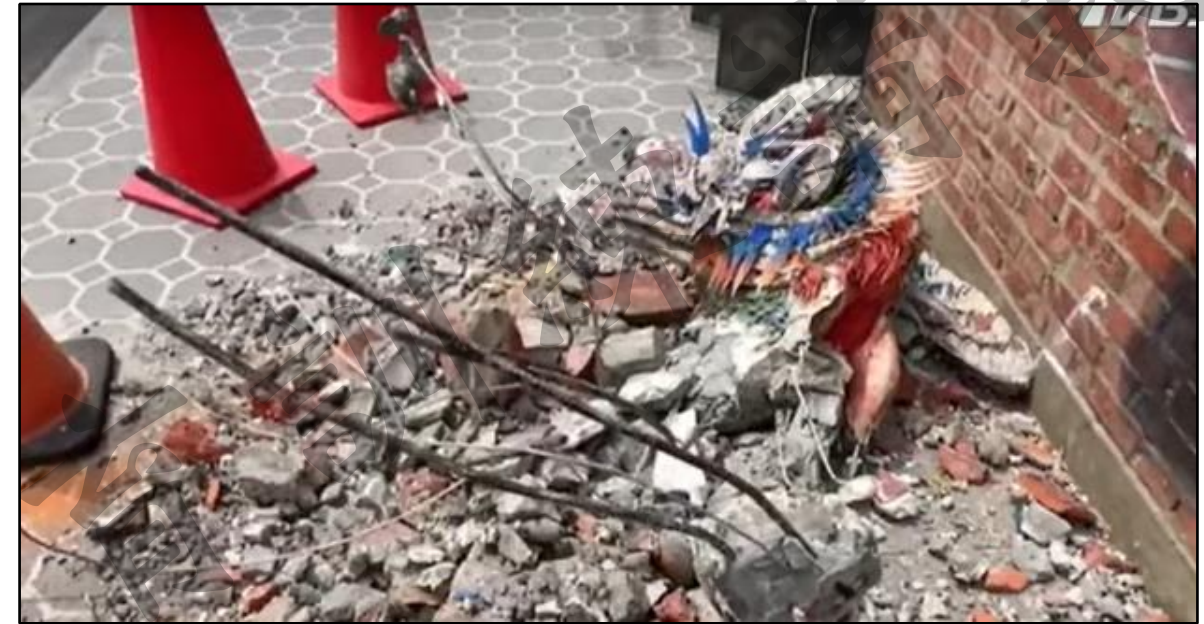
剪黏鋼筋未插入屋脊內容易滑落
