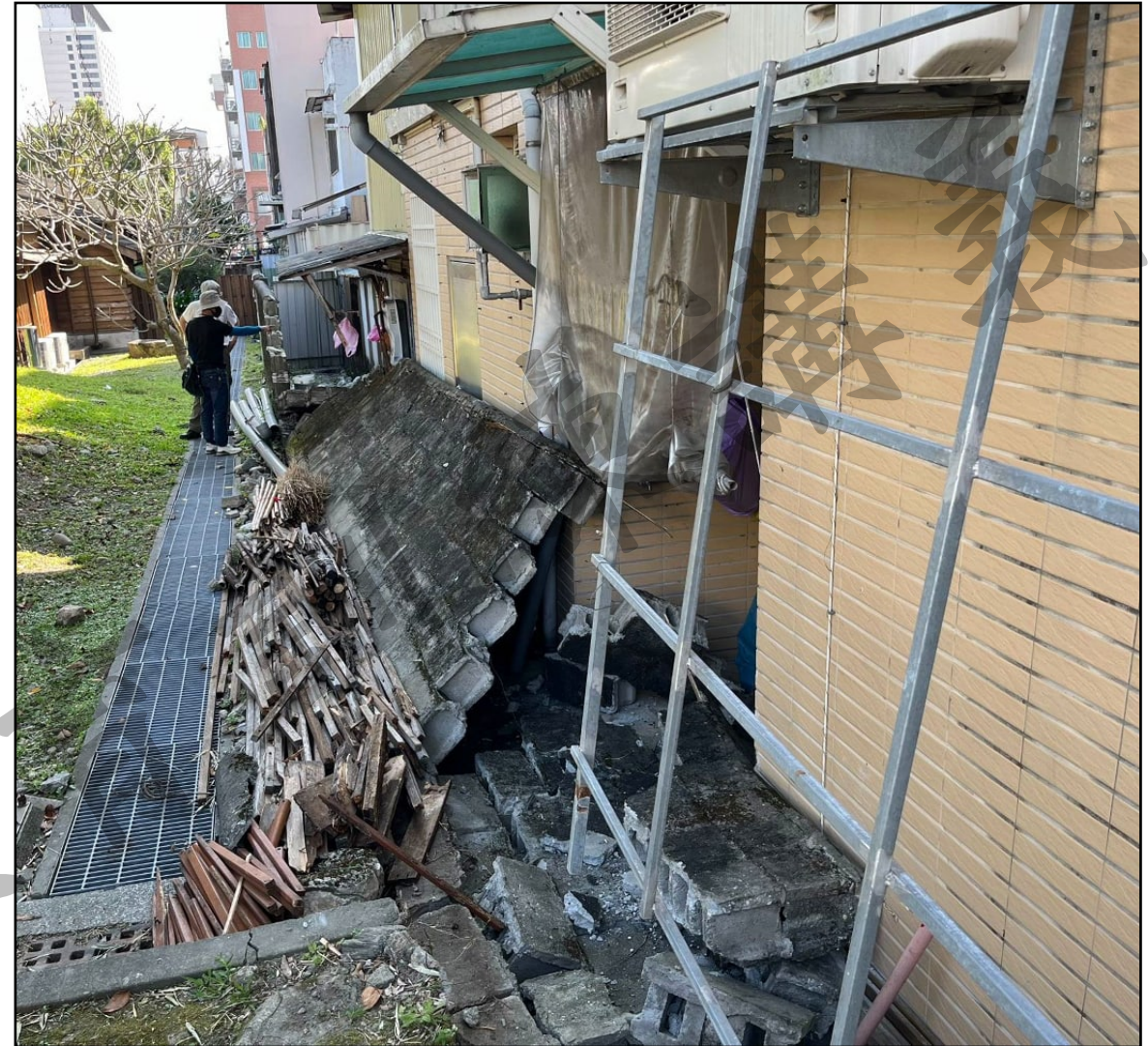
花蓮文創園區臨民宅邊圍牆倒塌（非古蹟本體）
