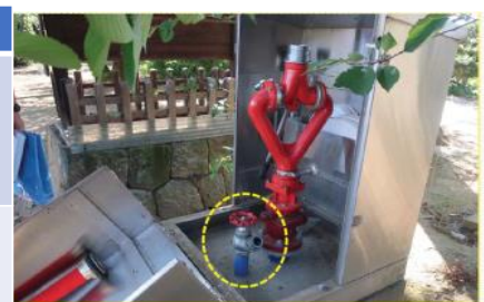
消防栓箱設有40MM小口徑連接口
